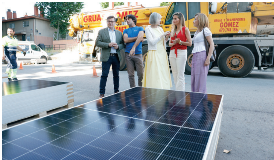
El delegado de Políticas de Vivienda, Álvaro González, y la concejala de Usera en el inicio de las instalaciones fotovoltaicas
